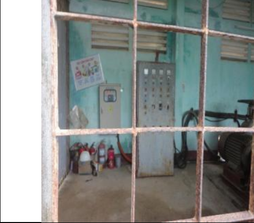
Các máy bơm và thiết bị sẽ được nâng cấp.
